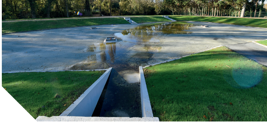
Travaux du bassin de gestion des eaux pluviales, Rue Aristide Briand à Niort
