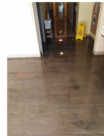
Inondation Accueil, vestiaires... suite à une rupture de canalisation alimentant la borne à incendie située sur le parking. 29 juillet 2021
